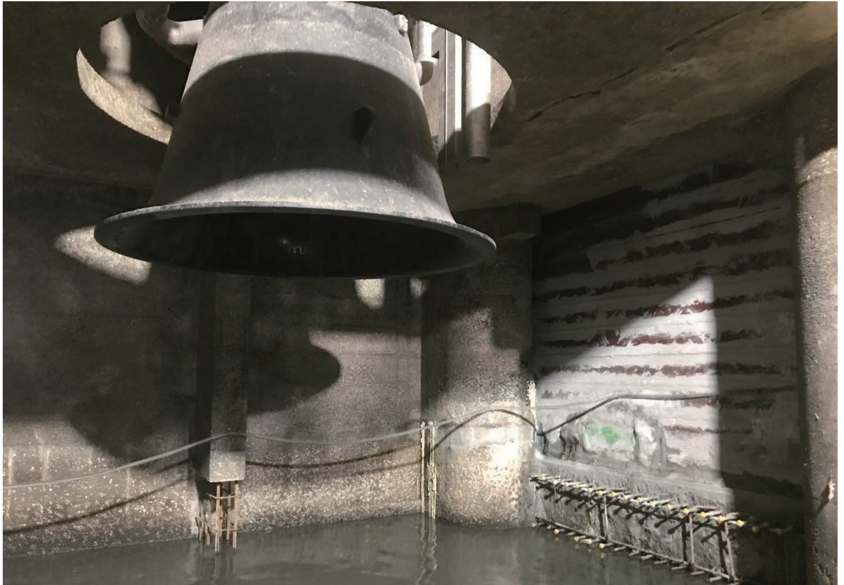
『釣鐘発見!?!』 通常は水面下に沈む巨大ポンプの吸い込み口が、メンテに伴う排水時などに姿を覗かせます。(三河島水再生センター 藍染ポンプ所) 動栄工業(株) 千田 龍也
