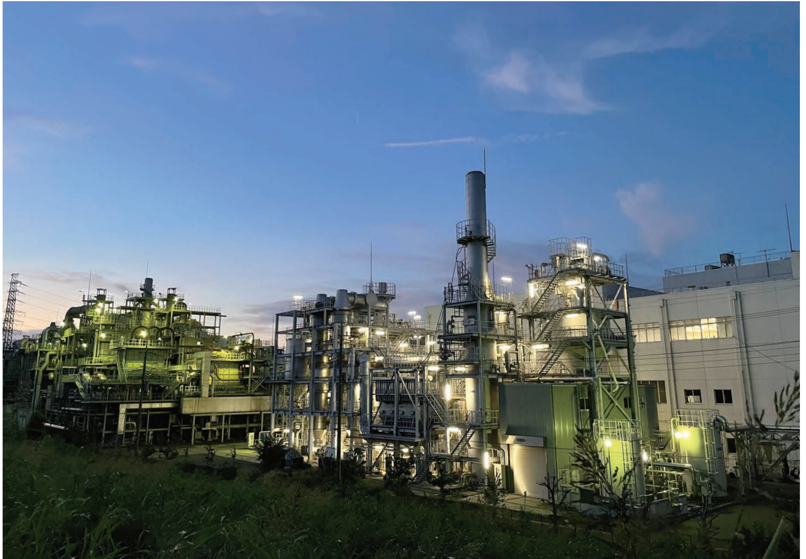
『黄昏時の焼却炉』 焼却炉で燃やされた汚泥は、灰になり、そして資源へと生まれ変わります。(荒川水循環センター)
