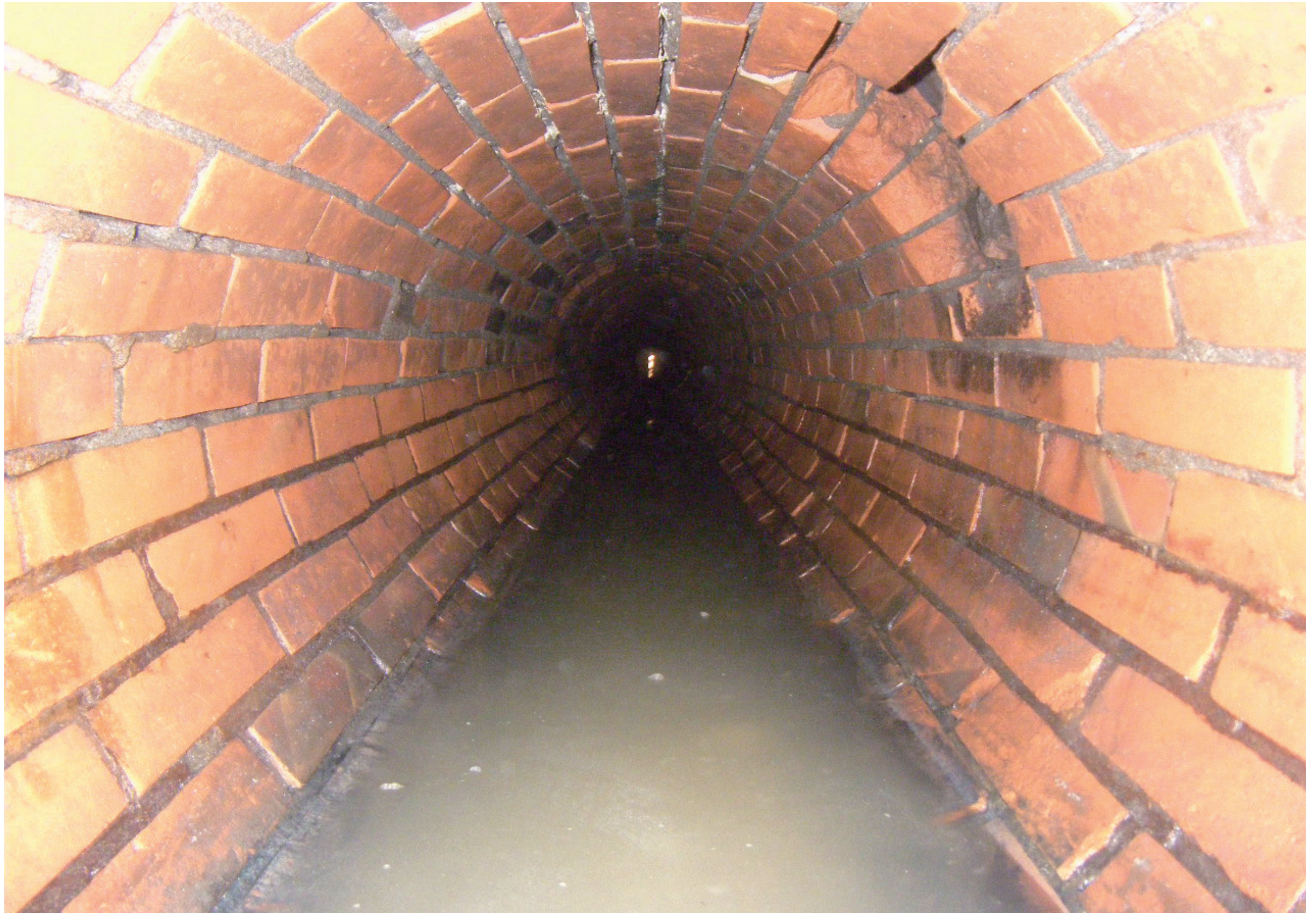
『レンガ造りの円形下水道管(φ600mm)』 先人の方々の技術に驚かされました。(千代田区岩本町)
