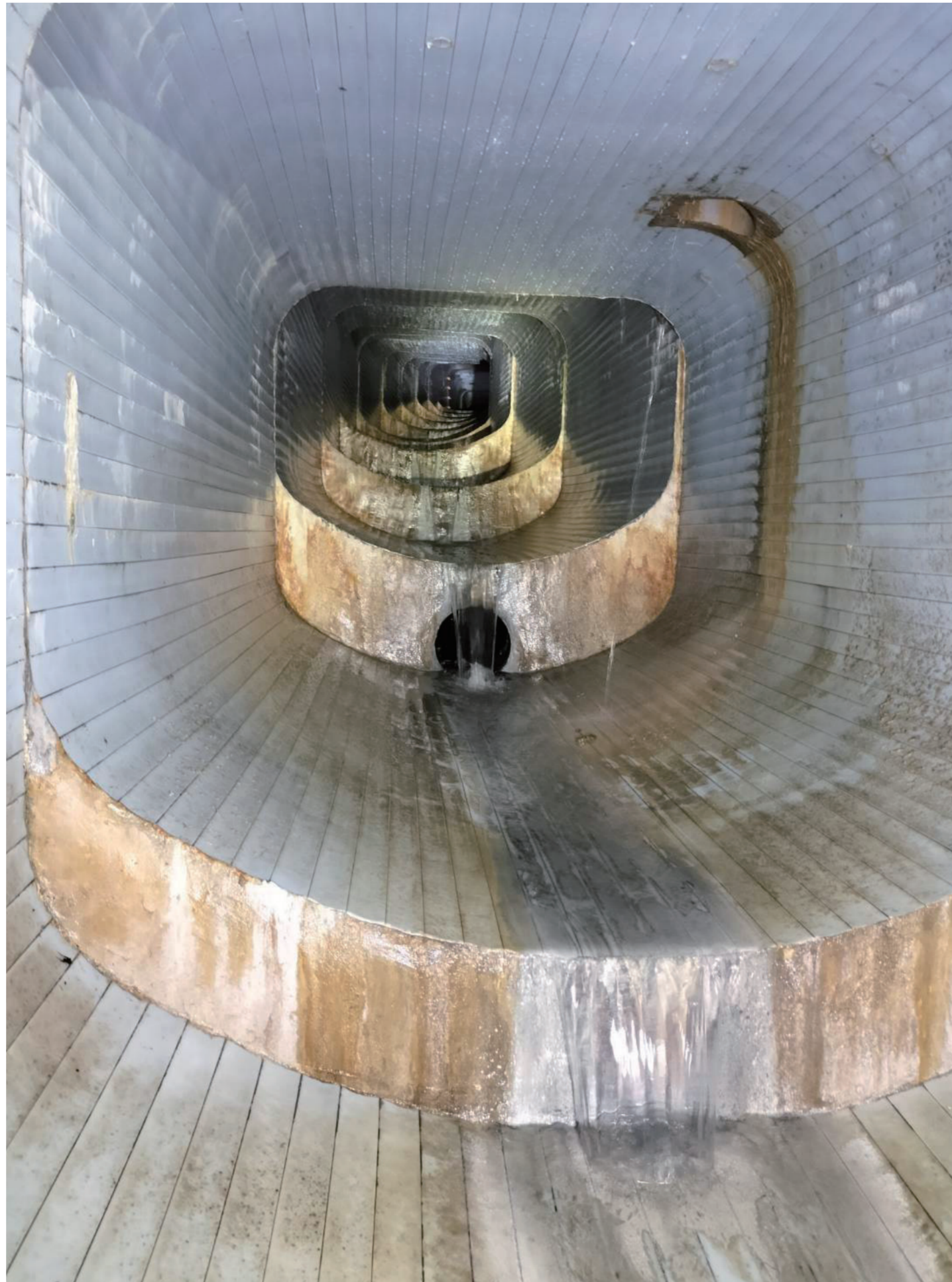
『下水の段々畑』 急勾配な箇所を丁寧に内面被覆しました。 松久建設(株) 松川 貴明 (新宿区内藤町一丁目)
