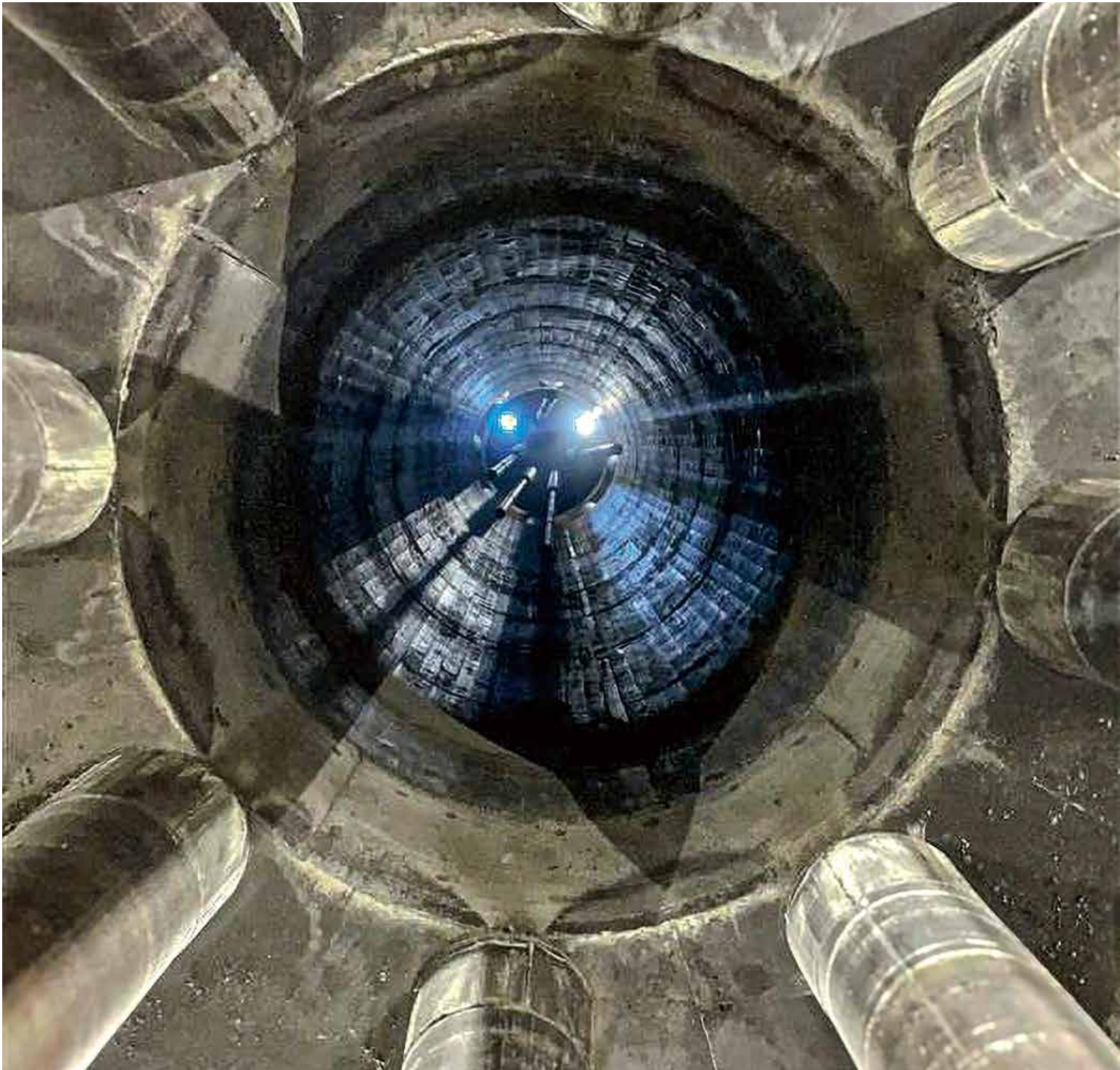
『 深淵をのぞくとき、深淵もまたこちらをのぞいている 』汚泥消化槽の中で陽光が二つ差し込み怪物がのぞき込んでるようにみえます。(水再生センター) 東信工業株式会社 原田 天魁
